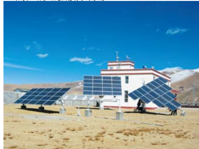
● 西藏羊八井多种光伏自动跟踪系统
