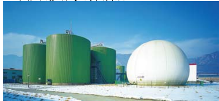
● 北京延庆2兆瓦生物燃气工程生产现场图片
