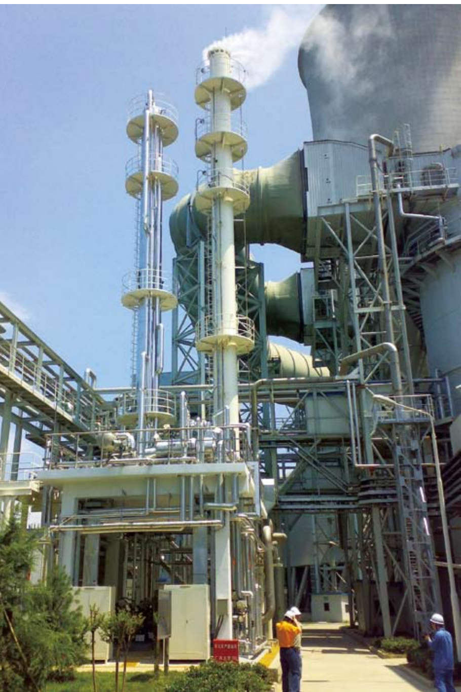
● 北京3000吨/年燃煤电厂二氧化碳捕获项目
